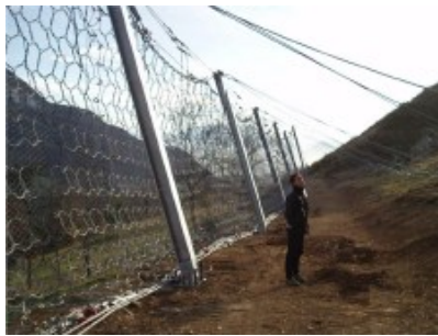
Ecran pare-blocs par une barrière flexible (Néron) (Crédit : Sage Ingénierie)
