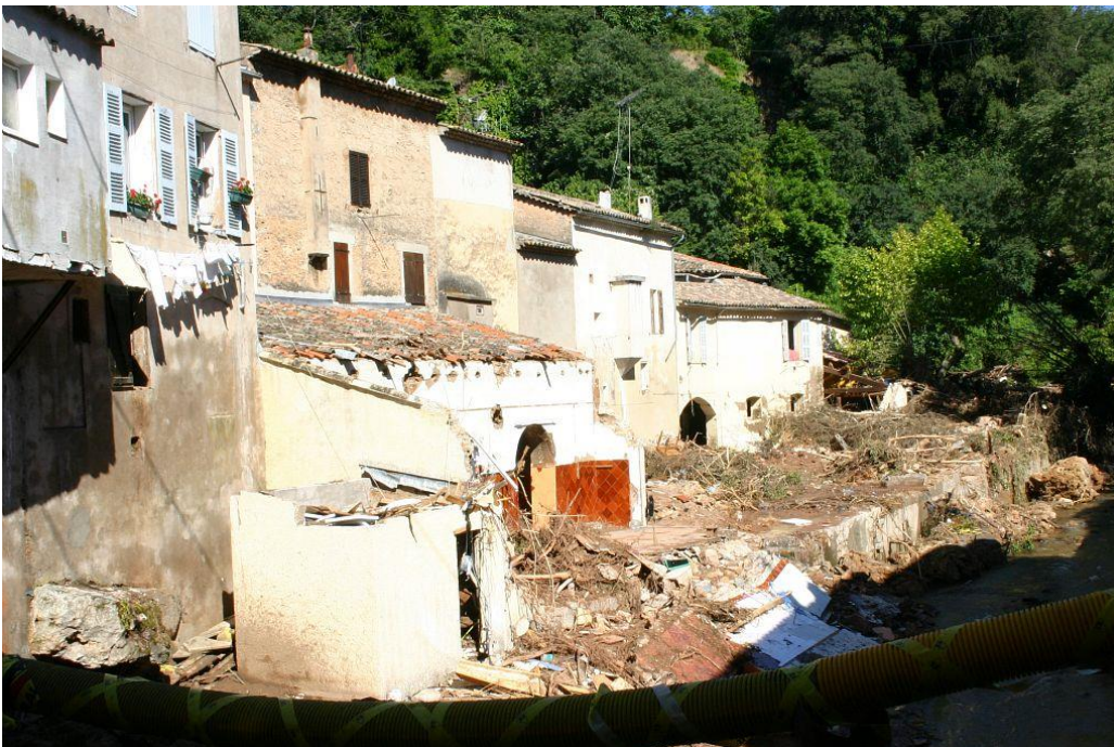
Figure 1 : Les Arcs sur Argens - dégâts suite à la crue et aux inondations 2010. Photo : C. Tailleux.
